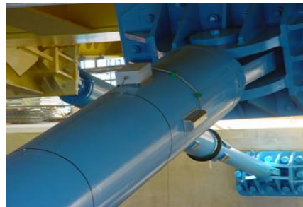
Αισθητήρες παραμόρφωσης στις ράβδους σύνδεσης καταστρώματος
